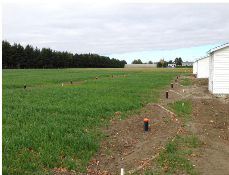
Figure 2: Avaloirs sur le site
