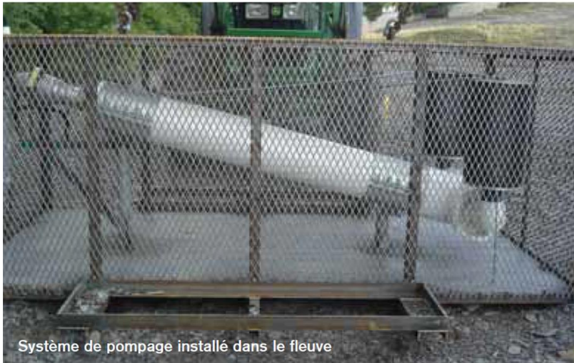
Figure 9.9 Cage de protection des crépines de pompage pour le prélèvement de l'eau au fleuve
