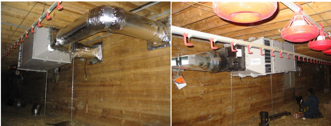
Figure 3: Installation à la Ferme du Grand-Orme
