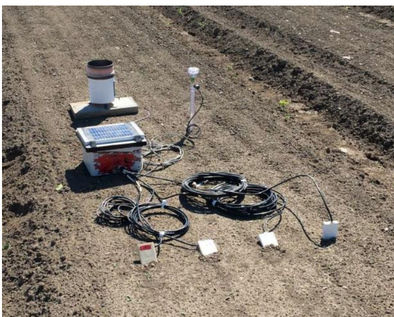
Figure 2.5.1. Station d'acquisition de données pour la gestion de l'irrigation.
