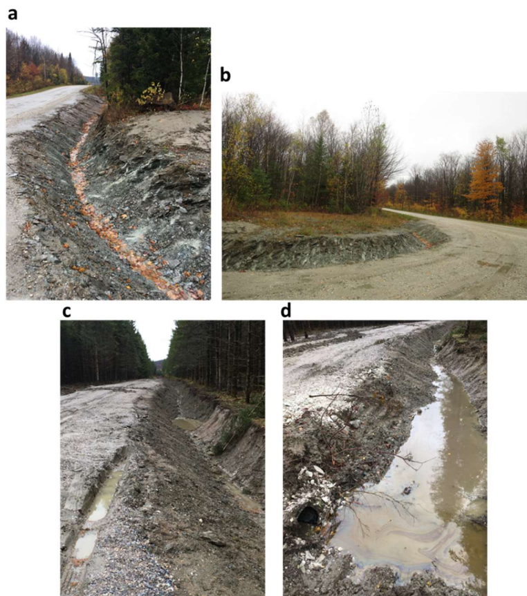
Figure 5. Routes non pavées de forte inclinaison (a et b) et chemins forestiers aménagés (c et d) dans le bassin versant du ruisseau Gobeil, 18 octobre 2019.
