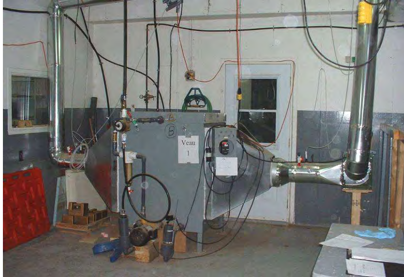
Figure 15. Unité expérimentale pour le traitement de l'air (UTA)
